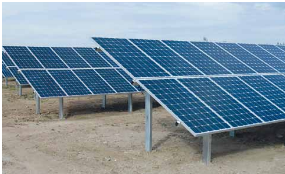
PV-Anlage in Wolframs-Eschenbach
