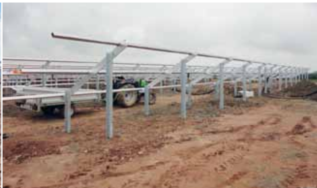
Unterkonstruktion für PV-Module
