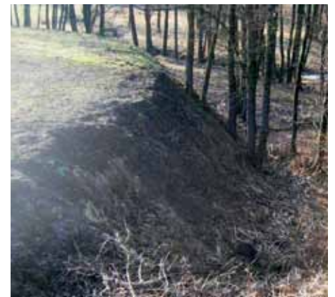
Deponieböschung vor der Sanierung mit zu starker Böschungsneigung
