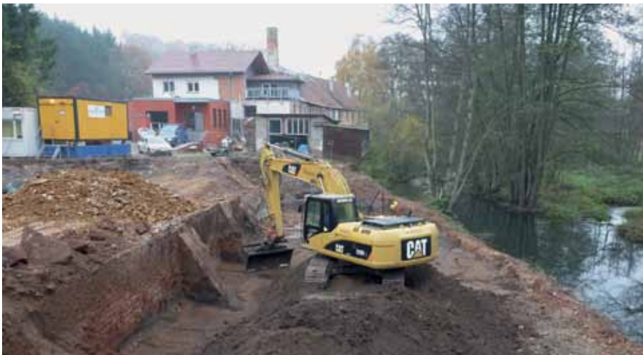
In der östlichen Sanierungsgrube wurde eine in Vergessenheit geratene Ufermauer parallel der Wern entdeckt. Im Hintergrund die Gebäude der Gipsmühle.
