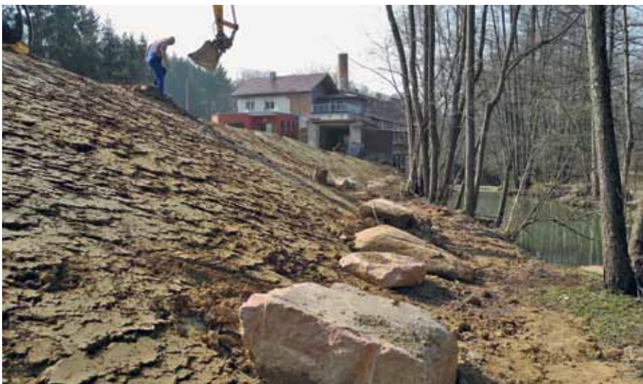
Zum Abschluss der Sanierung wurden die Baugruben mit schwach belasteten Aushub der Sanierung (Z 0 / Z 1.1 nach LAGA Boden) sowie mit Böden aus der Umgebung aufgefüllt. Die neue Hochfläche im Höhengniveau der Bestandsgebäude wird zur Wern hin von einer Uferböschung begrenzt, die in einen Uferstreifen ausläuft. Im Aushub wurden Felsblöcke aus dem ortstypischen Buntsandstein separiert und als Strukturelement bzw. Erosionsschutz am Böschungsfuß eingesetzt.
