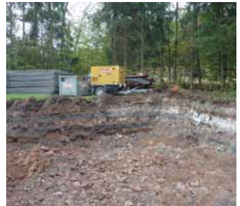
Am Rande der Sanierungszone Schrottplatz wurden Ablagerungen aus den Zeiten der Gipsproduktion freigelegt: Wechsellagerungen aus weißen Gipsabfällen und schwarzen Aschen- und Schlackenlagen.
