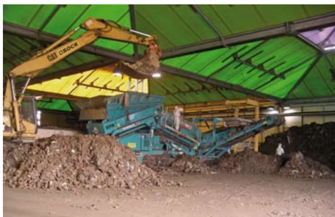
Off-site Behandlungsanlage (Trockenklassierverfahren)
