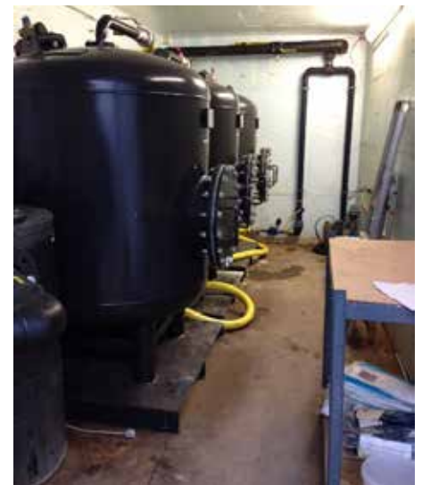
WAK Filter im mittleren Anlagencontainer (Bild 2)
