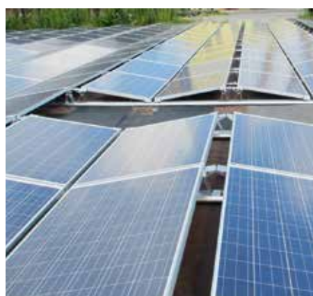
Bodenliegende Anlage in Ost-West-Ausrichtung
