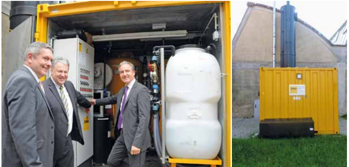
Inbetriebnahme der Grundwasserreinigungsanlage am 23. Juli 2015 V.l.n.r.: Joachim Neuß, 1. Bürgermeister der Stadt Auerbach i.d.OPf., Richard Reisinger, Landrat Landkreis Amberg-Weizsach, Michael Kremer, Geschäftsführer der GAB
