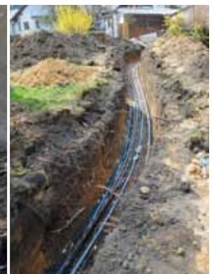
Graben mit Zu- und Ablaufleitungen
