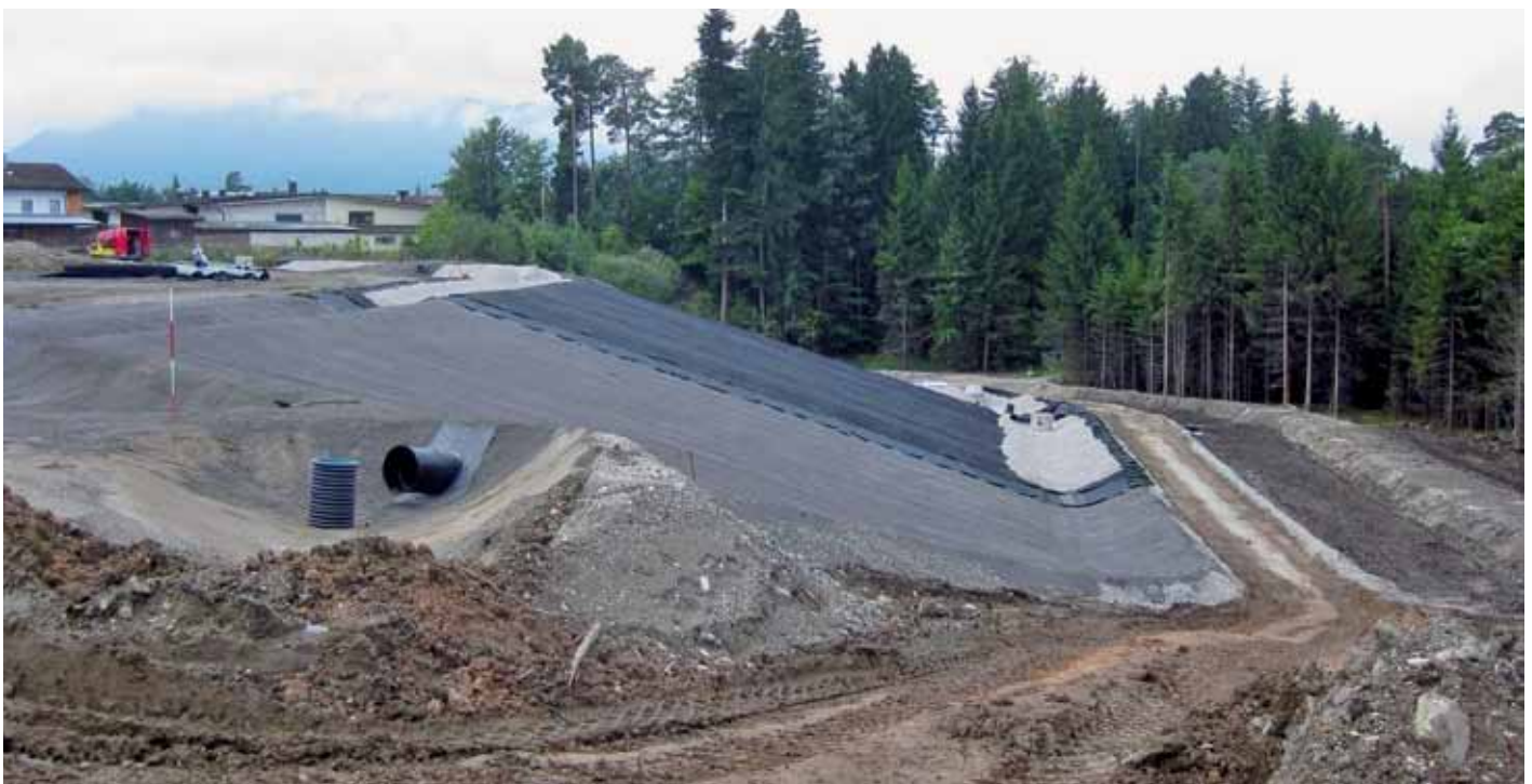
Westliche Böschung nach Abflachung mit Sickermulde (zu sehen am rechten Bildrand), im Bildzentrum: Gasdrainschicht, KDB, Drainmatte, im linken Vordergrund: Durchdringung der Entwässerungsleitung zur Sickermulde durch die KDB
