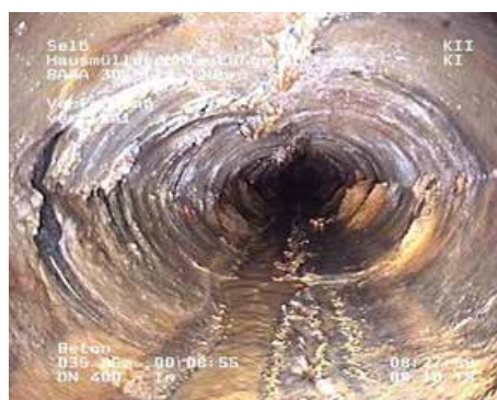
Grunddurchlass 2018 mit Deformationen (W. Böhme GmbH, 2018, in R&amp;H, 2019) (6)
