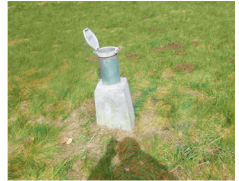
2) Angefahrene Messstelle, in ca. 0,5 m Tiefe ist das Vollrohr abgesichert – direkter Zufluss von Oberflächenwasser in das Grundwasser ist gegeben.
