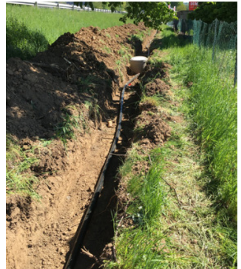
Abb. 6: Ablaufleitung von der Sanierungsanlage zum Mühlbach; oben links die Bundesstraße B289 / B85
