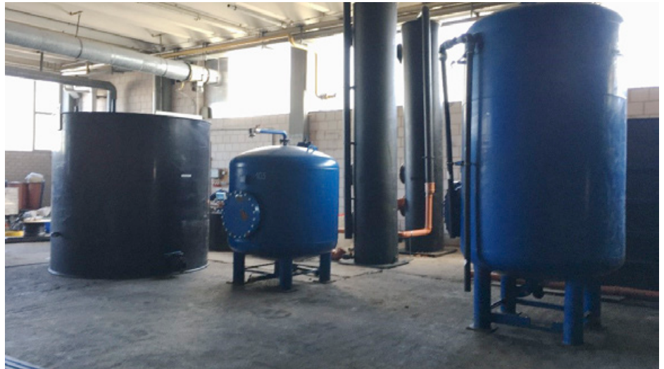
Abb. 7: Strippanlage mit vorgeschalteter Enteisung / Entmanganung
