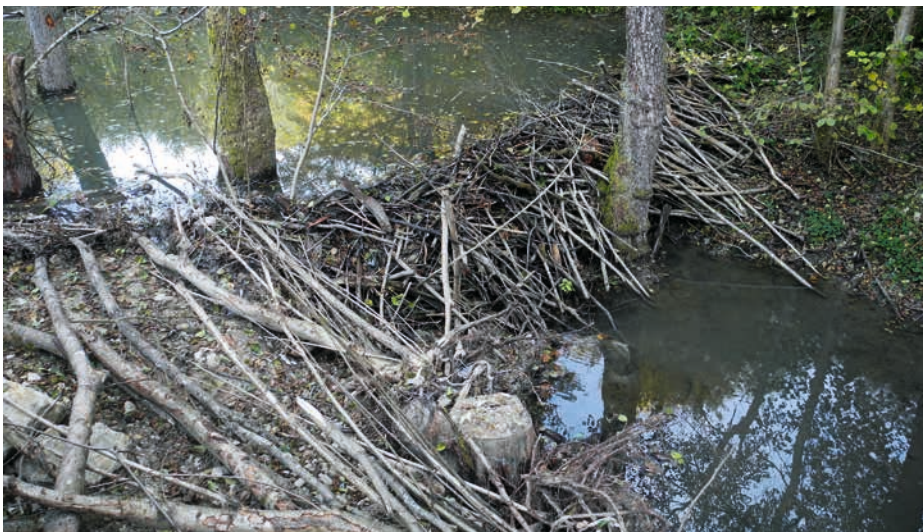
Unerwartete Komplikation in der Bauausführung: Vor Beginn der Baumaßnahme siedelte sich eine Biberfamilie an, baute einen Damm und setzte teilweise das Baufeld unter Wasser.
