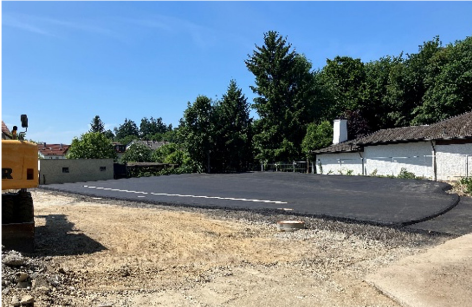
Mit Asphalt versiegelte Gebäudeaufstandsfläche (8)
